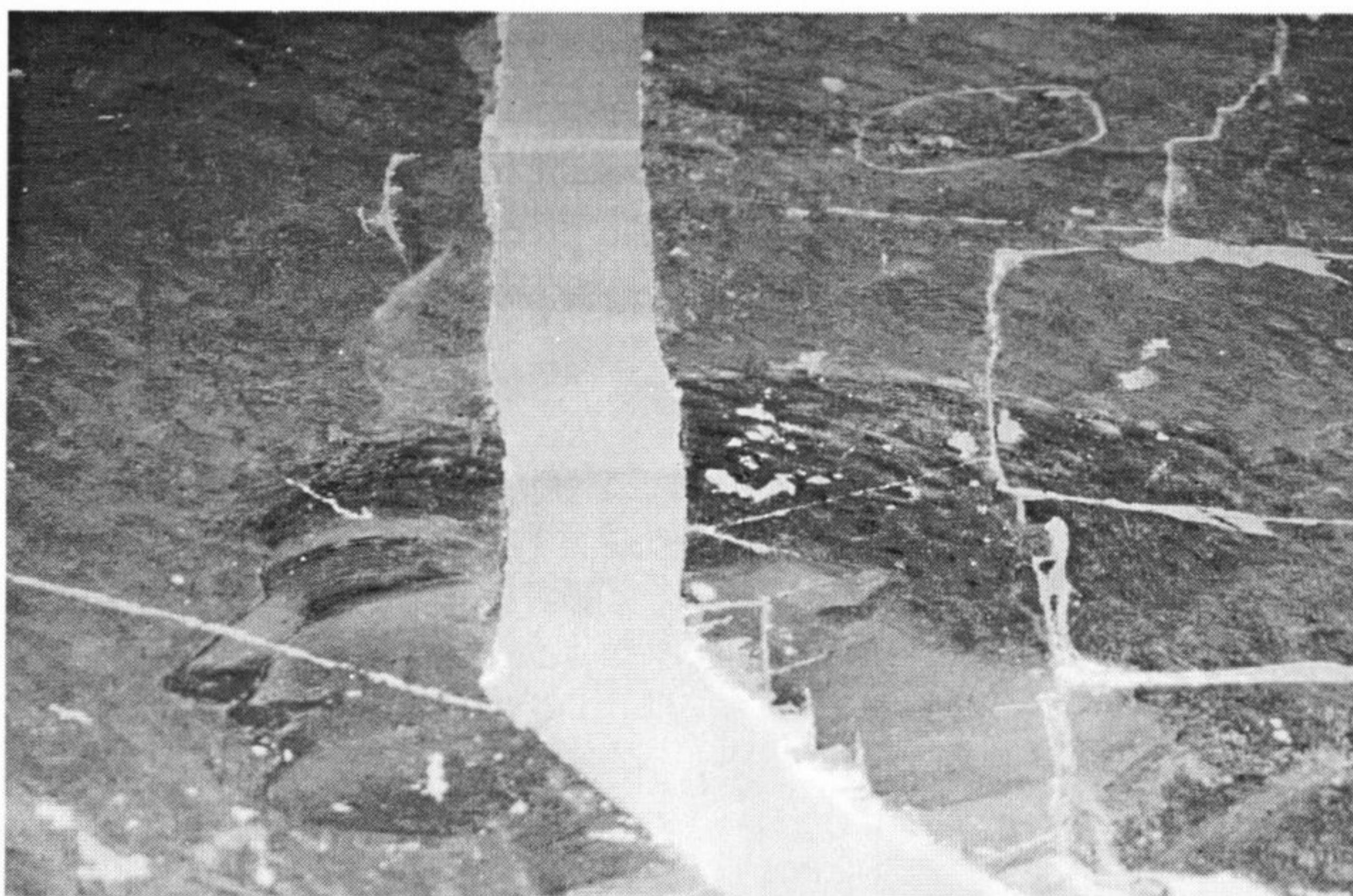
Foto 2 – Demonstrativo parcial de um dos rasgos que a obra sofreu.
