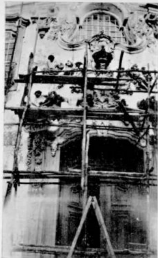
Igreja de Nossa Senhora do Carmo, Ouro Preto. Restauração da porta principal.
