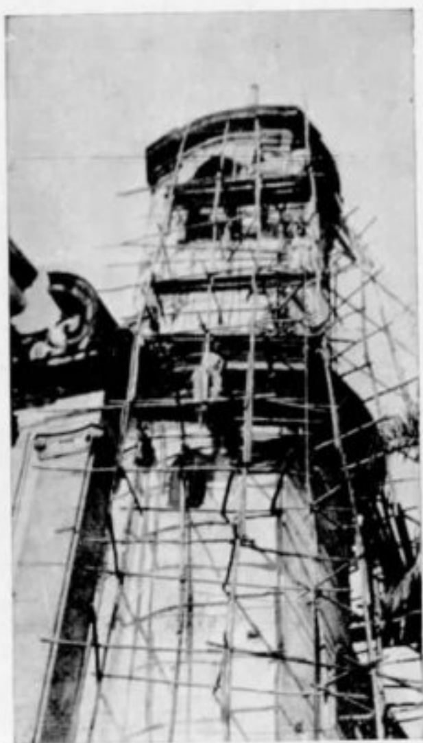
Igreja de Nossa Senhora do Carmo. Fachada principal restaurada. A tórre do lado direito em recomposição.
