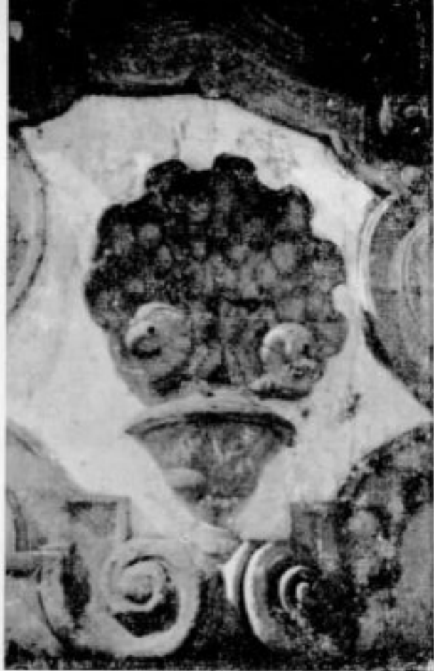
Chafariz dos Contos, Ouro Preto. Estado em que se achava a parte central.
