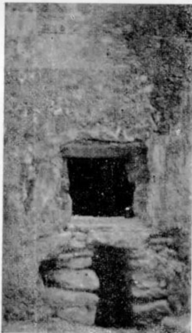
Estado em que se encontrava um dos registros das canalizações de água de Ouro Preto nos tempos coloniais.
