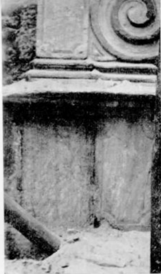
Chafariz dos Contos. Estado de ruína da base do lado direito.
