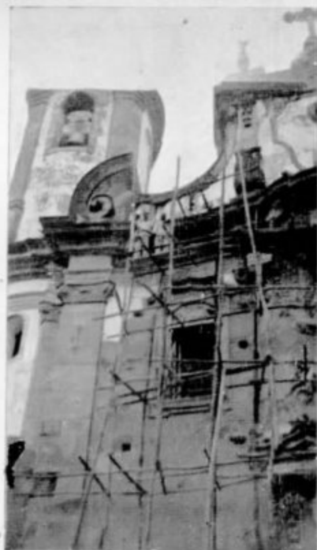
Igreja de Nossa Senhora do Carmo. Fachada principal em vias de restauração.
