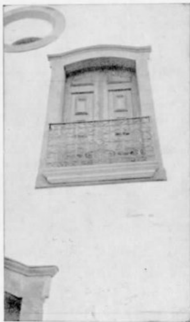
Igreja de Nossa Senhora do Carmo. Pano da fachada lateral direita restaurado pela Inspetoria de Monumentos Nacionais.
