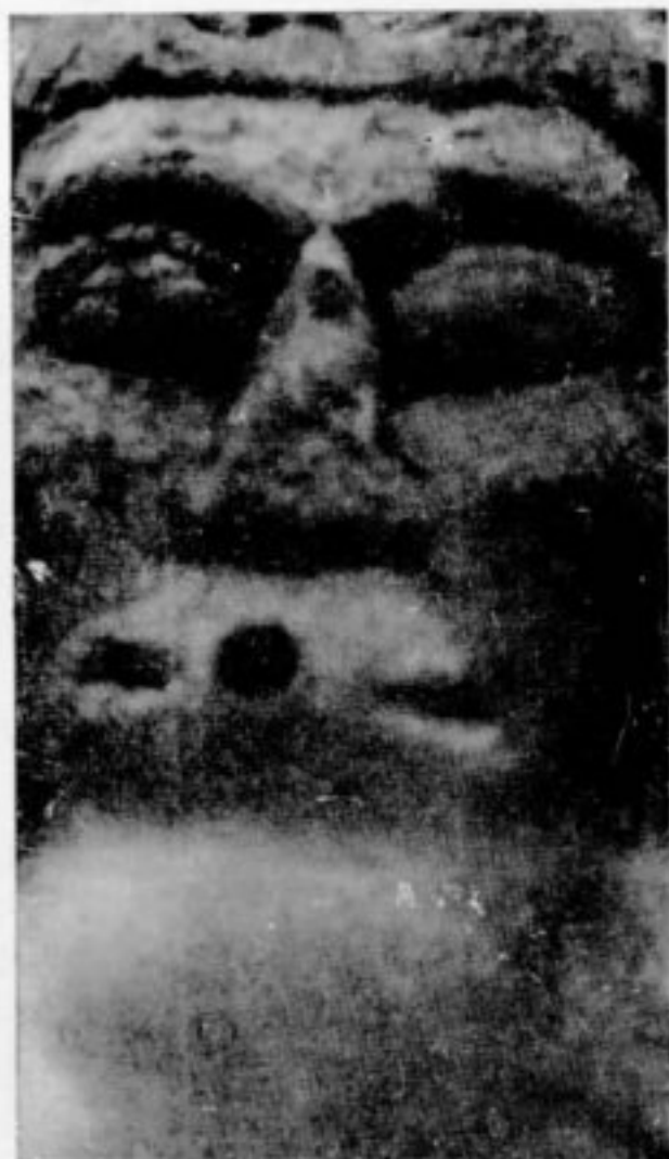
Chafariz de Marília. Estado de ruína duma das carrancas.
